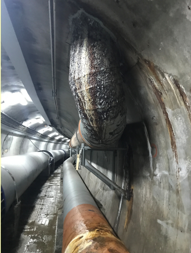
Εικ. 2 & 3 Ενδεικτική απεικόνιση παρατηρούμενων εισροών στη σήραγγα από κατασκευαστικούς αρμούς και ρωγμές
